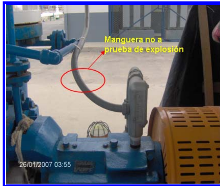
Figura 2.27 Manguera de conexión no a prueba de explosión.
