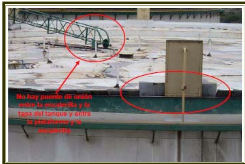
Figura 2.24 No hay puente de unión equipotencial
