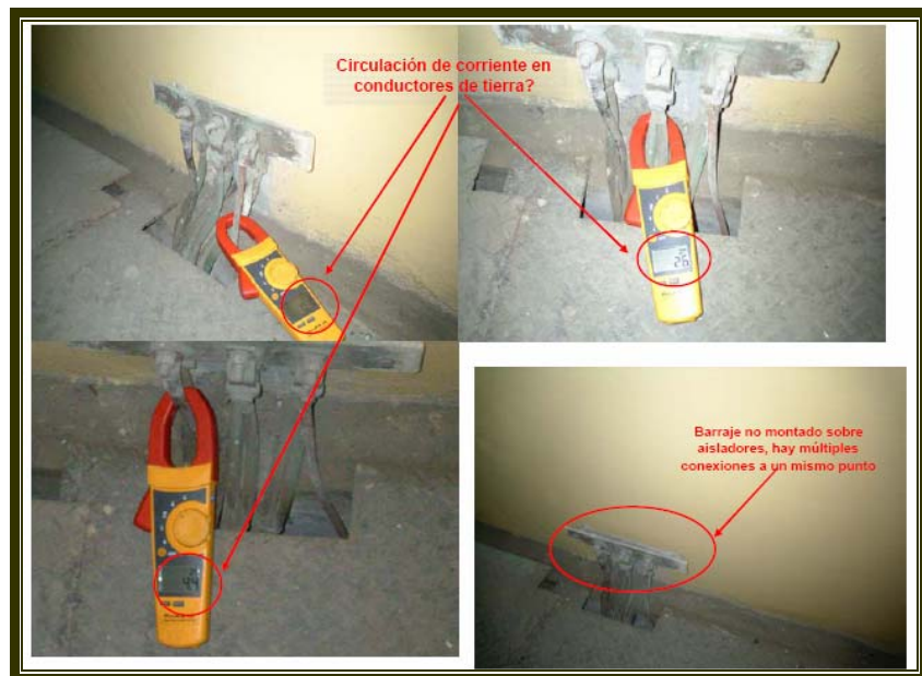
Figura 2.17 Barraje no montado sobre aisladores
