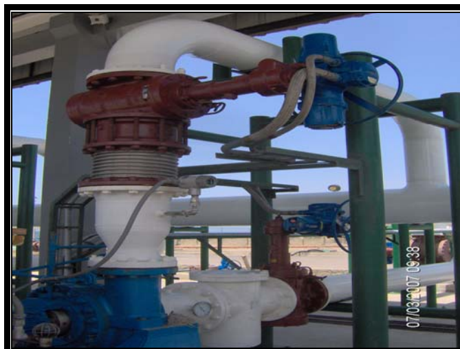
Figura 3.4 Área de bombas
