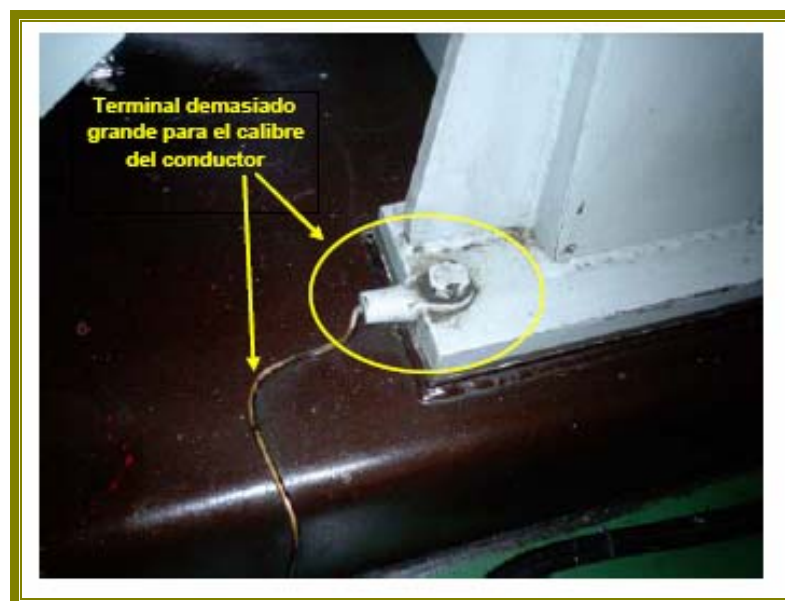
Figura 2.12 Terminal demasiado grande para el calibre del conductor
