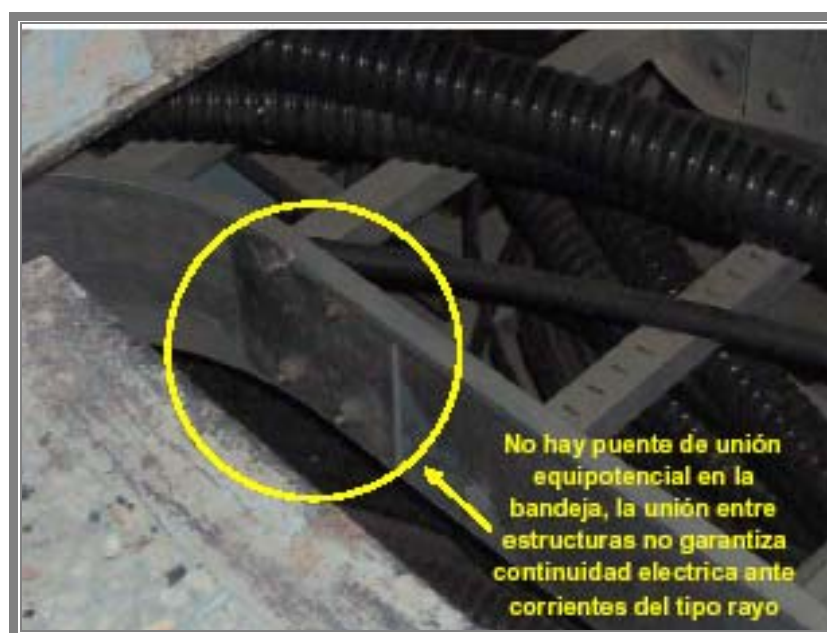
Figura 2.31 No hay puente de unión equipotencial en la bandeja.
