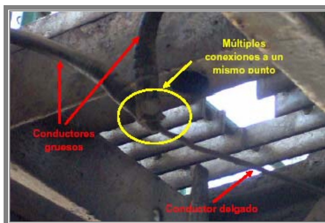
Figura 2.38 Conexiones inapropiadas y en mal estado.
