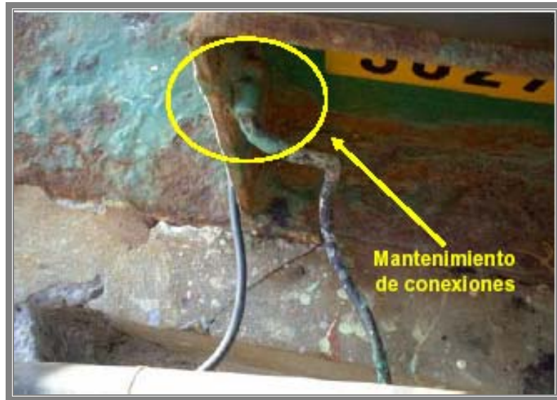
Figura 2.52 No hay mantenimiento de conexiones.
