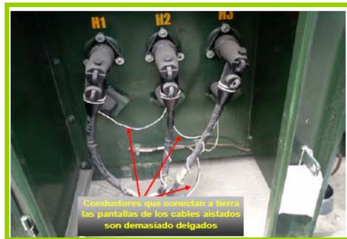
Figura 2.6 Conductores que conectan a tierra las pantallas de los cables aislados son demasiado delgados
