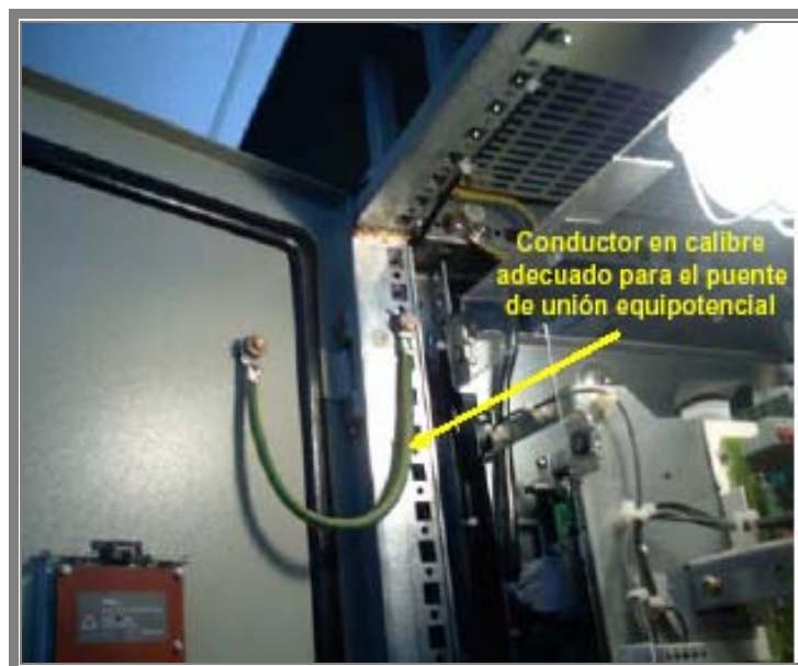
Figura 2.34 Conductor con calibre adecuado
