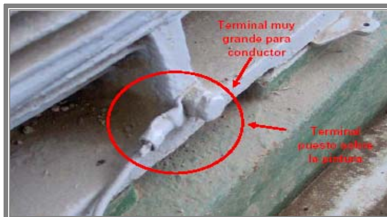
Figura 2.42 Terminal muy grande para conductor
