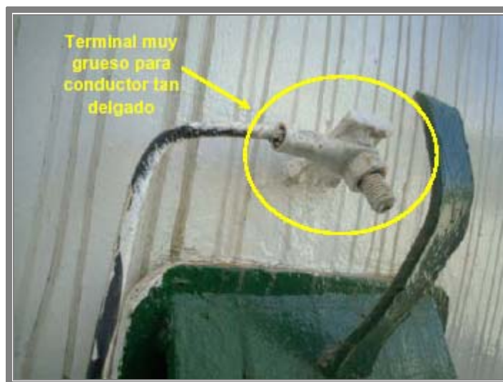
Figura 2.47 Terminal muy grueso para conductor tan delgado.
