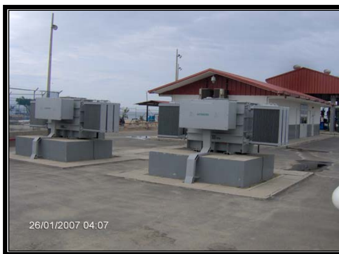
Figura 3.2 Área de transformadores
