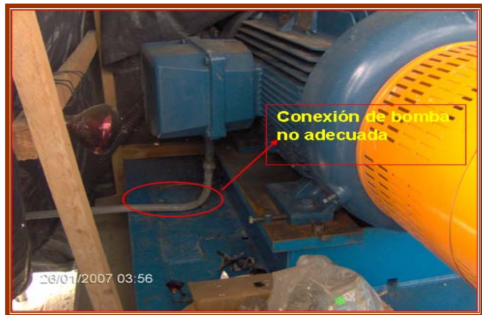
Figura 2.29 Conexión no apropiada para la bomba
