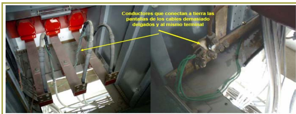
Figura 2.8 las barras no están montadas sobre aisladores
