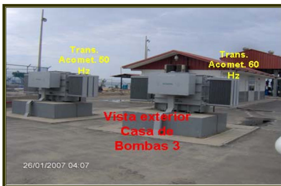
Figura 2.26 Vista exterior casa de bombas 3
