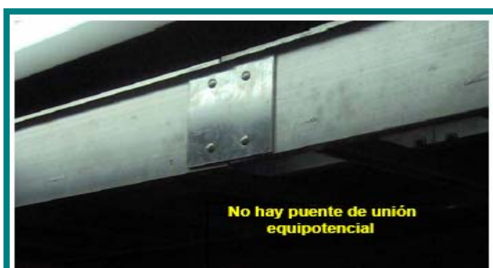
Figura 2.5 No hay continuidad eléctrica
