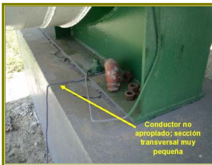
Figura 2.46 Conductor no apropiado; sección transversal muy pequeña.
