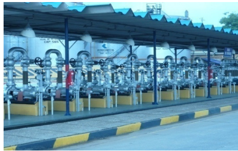
Figura 4-28. Bombas del sistema actual
