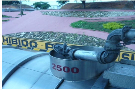
Figura 4-26. Despacho de combustible hacia el auto tanque
