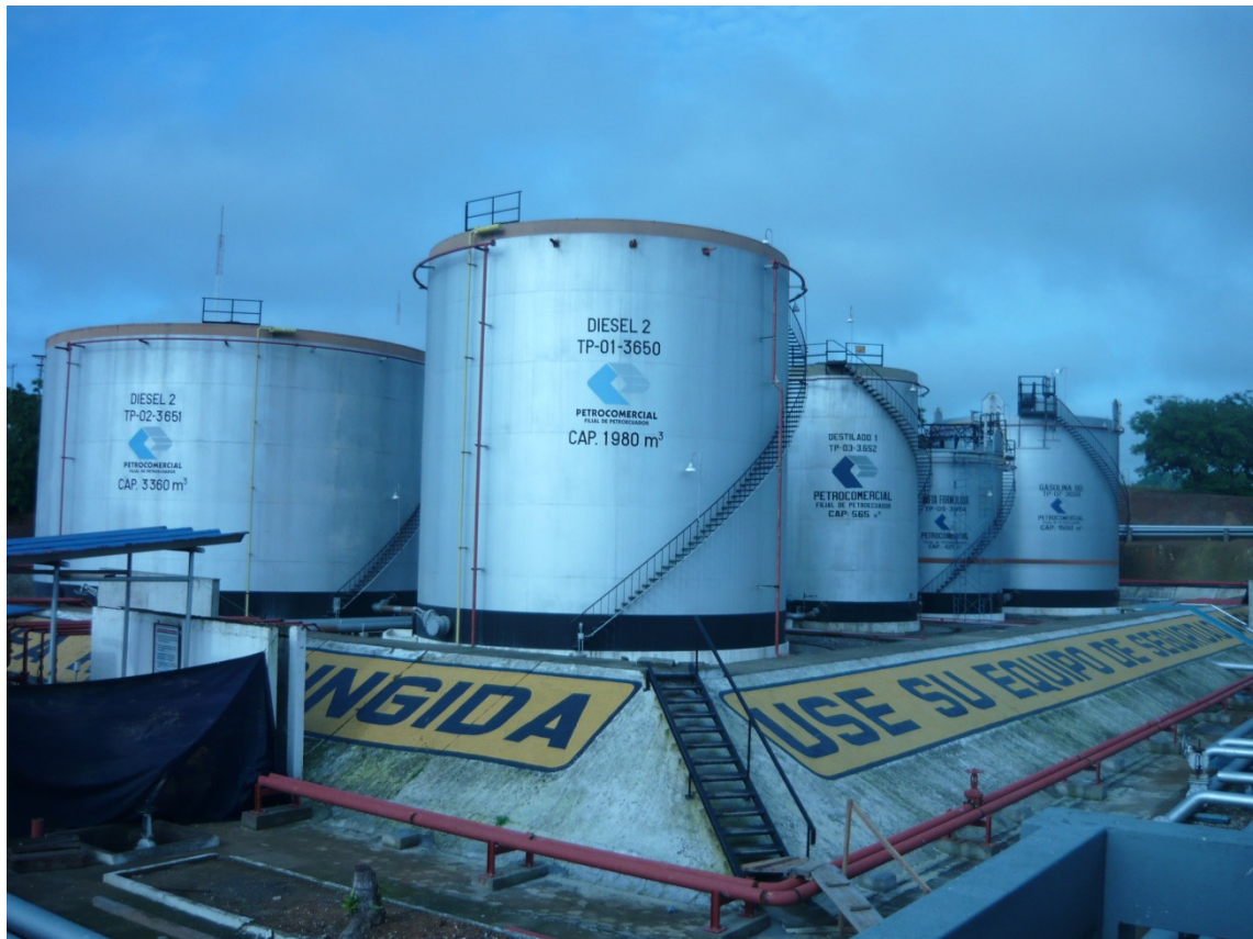
Figura 1-2. Tanques de distribución
