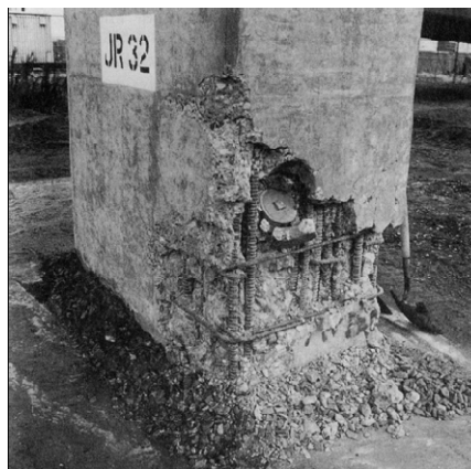
Figura 3.18: Falla por falta de longitud de traslape en la base de la columna. Terremoto de Loma Prieta, 1989. (Tomada de Priestley, Seible y Calvi, 1996)
