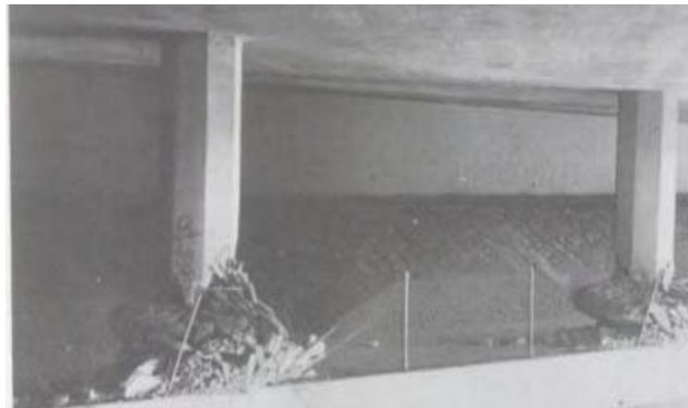
Figura 3.20: Rótulas plásticas en columnas restringidas por un muro que las conecta en el Puente sobre el Canal Bull Creek Canyon. (Tomada de Priestley, Seible y Calvi, 1996)
