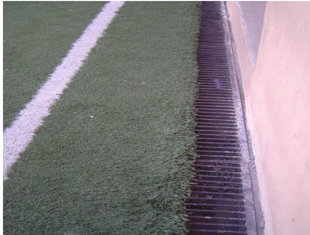
Canales de Drenaje
