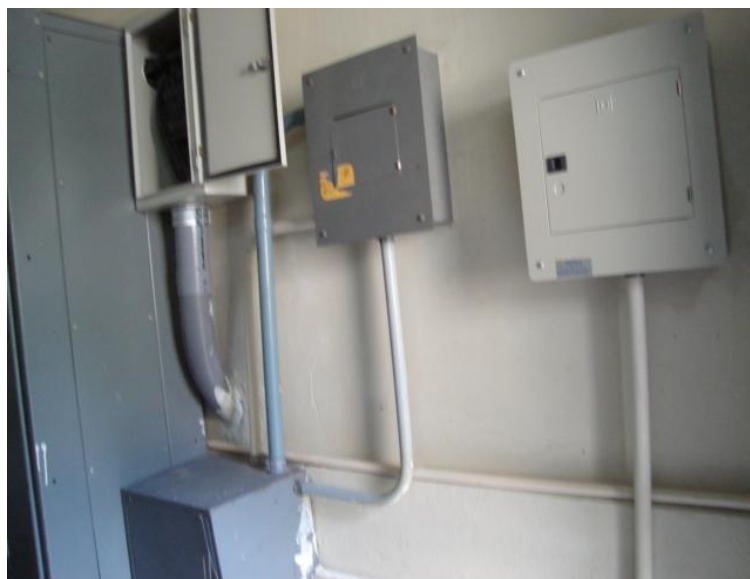
Figura 15. Tablero de distribución en subestación eléctrica “C/T22”.
