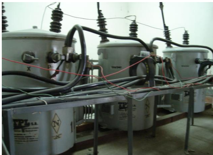
Figura 12. Banco de transformadores en subestación eléctrica “C/T21”.
