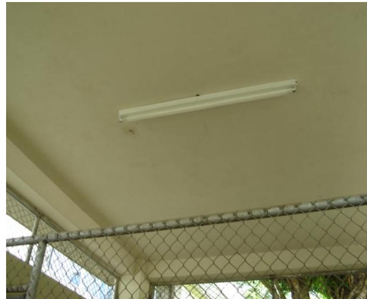
Figura 30. Iluminación insuficiente en subestación eléctrica "C/T 23".
