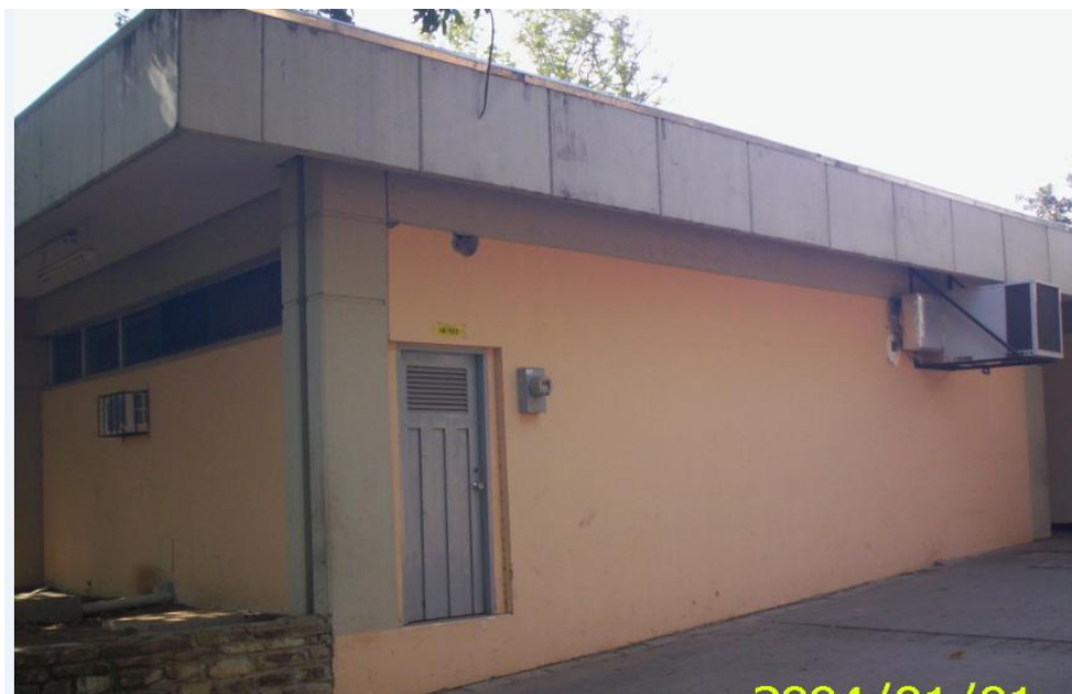
Figura 6. Vista exterior de subestación eléctrica “C/T 21”.
