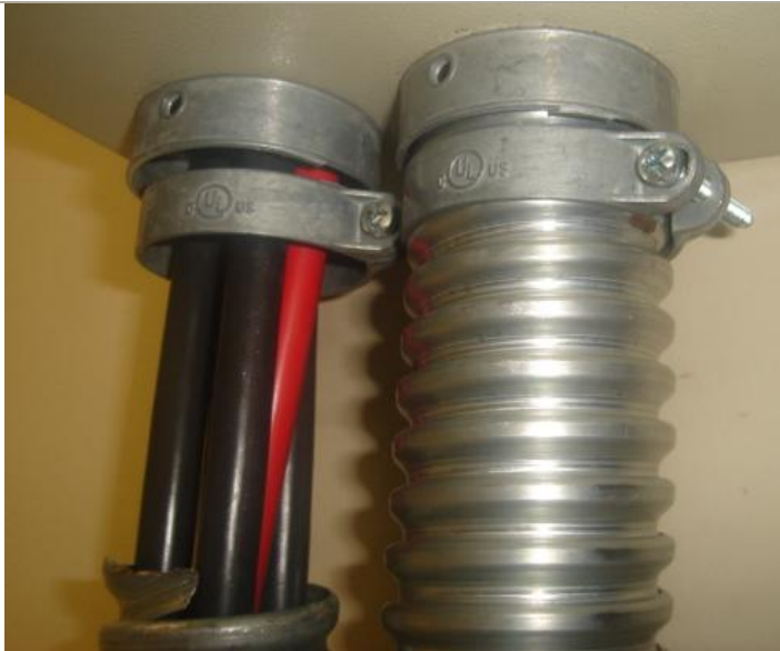
Figura 37. Forma errónea de instalar una funda sellada.
