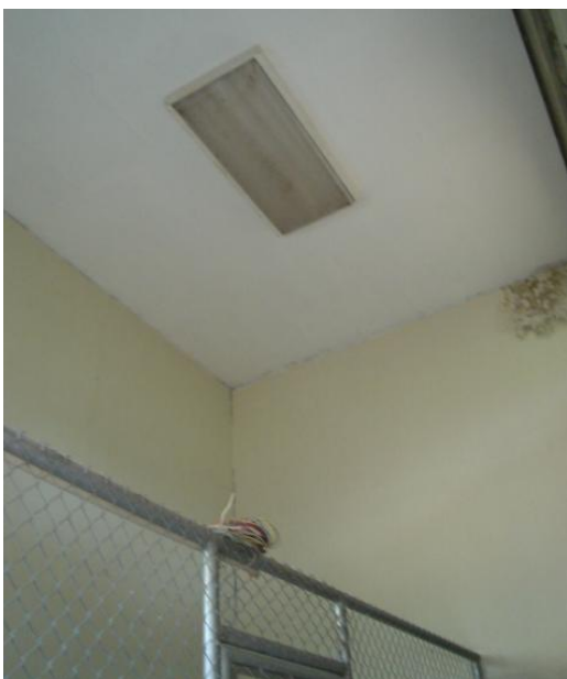
Figura 31. Iluminación mal ubicada en subestación eléctrica “C/T 21”.
