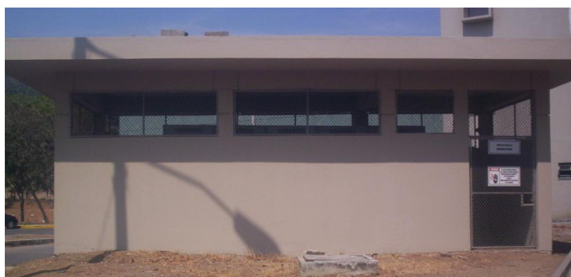
Figura 1a. Celda de media tensión para la FIEC.
