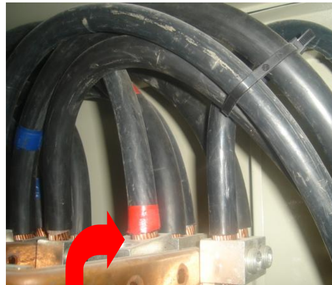
Figura 24. Evidencia del retiro incorrecto del revestimiento en conductores.
