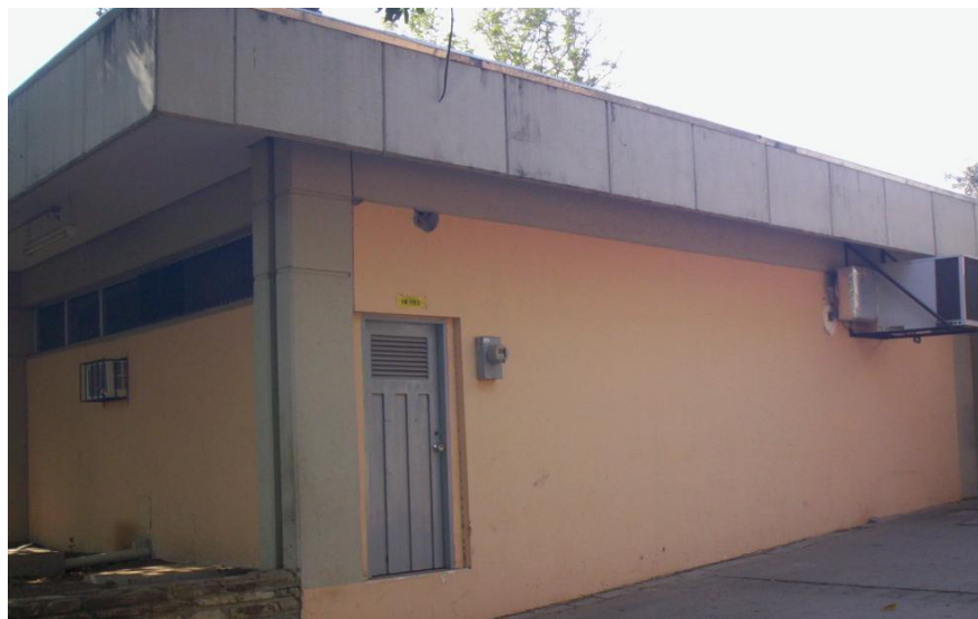
Figura 32. Aberturas de ventilación en subestación eléctrica “C/T 22”.
