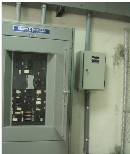
Figura 13. Tablero de distribución en subestación eléctrica “C/T21”.
