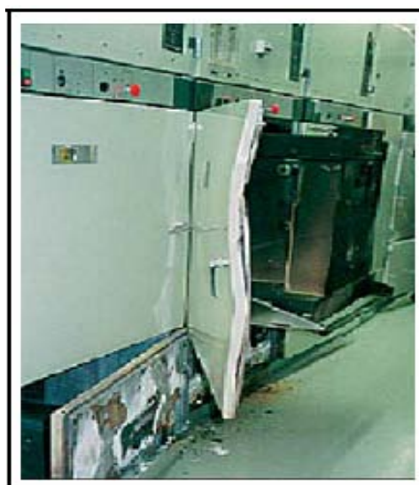
FIGURA 2.6 Consecuencia producida por una explosión
