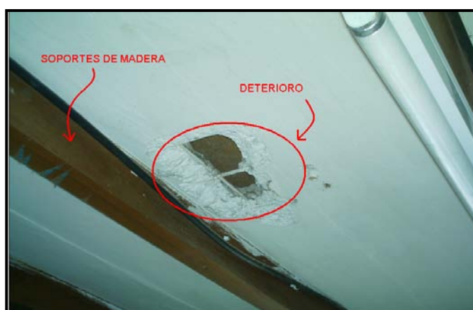
FIGURA 5.3 Deterioro encontrado en el cuarto de tableros
