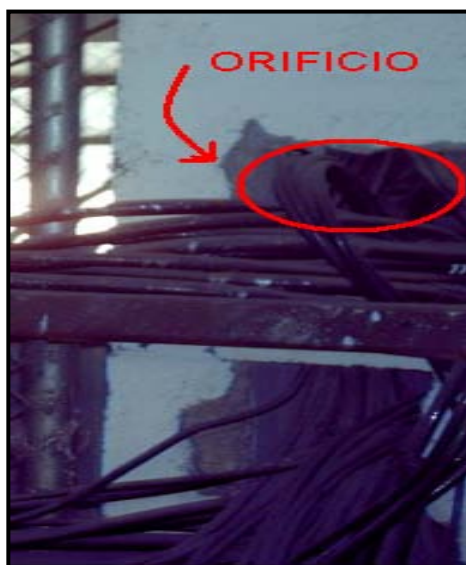
FIGURA 5.6 Falta de tubo con borde lisos para traspaso de conductores.
