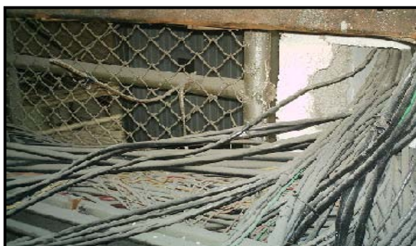
FIGURA 1.9: Acumulación de polvo en conductores
