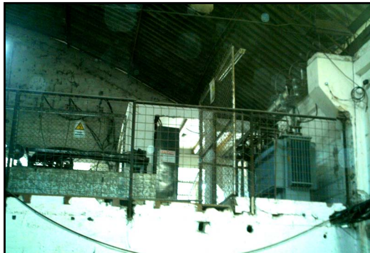
FIGURA 1.2 Subestación Tipo Interior.
