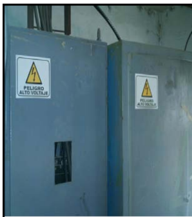
FIGURA 1.8 Tableros de distribución subestación REPLASA
