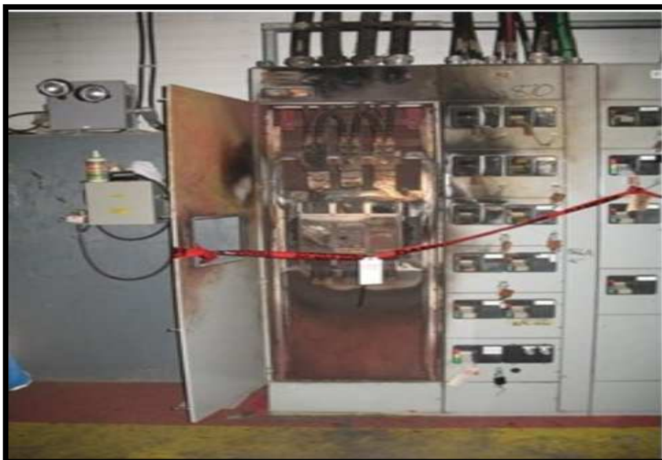
Fig. 2 Ejemplo de Corto circuito por corrosión de las piezas y contactos
