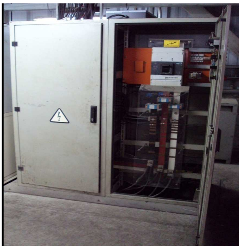
Fig. 4 Tablero de 380V
