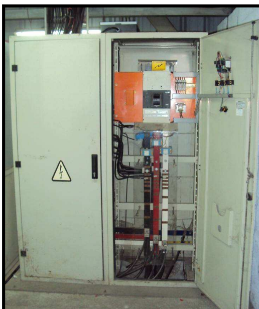
Fig. 9 Disyuntor principal de 1000Amp
