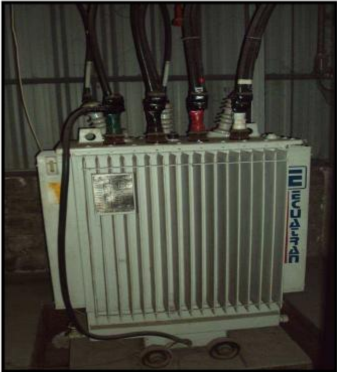
Fig. 12 Transformador de 500KVA IPAC S. A.
