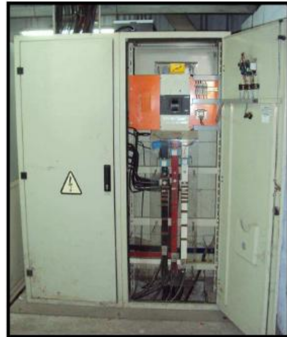
Fig. 9 Disyuntor principal de 1000Amp
