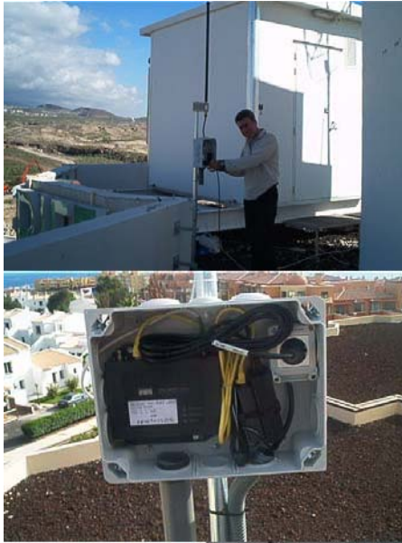
Figura 6.1-3 Instalación AP Externos
