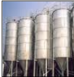
Fig.2.1 Silos de almacenamiento
