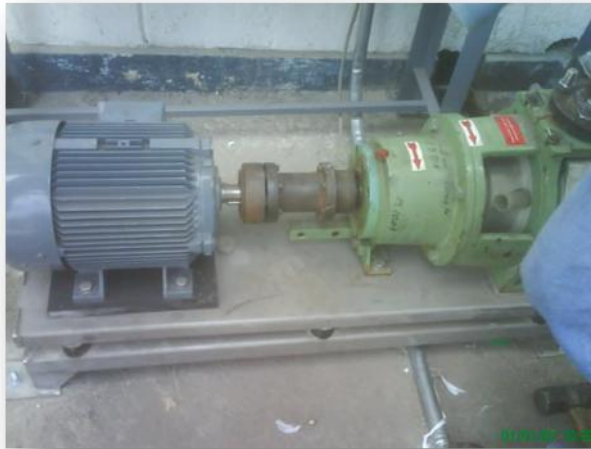
FIGURA 5.3. BOMBA PARA AGUA DESTILADA QUE ENTRA EN LAS BATERIA
