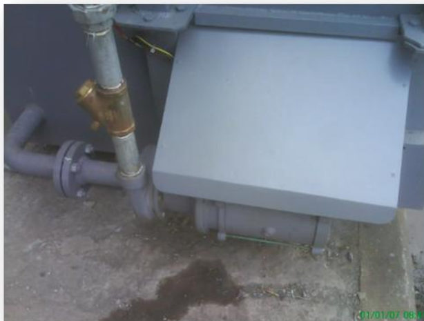
FIGURA 5.4. BOMBA DE AGUA PARA TORRE DE ENFRIAMIENTO
