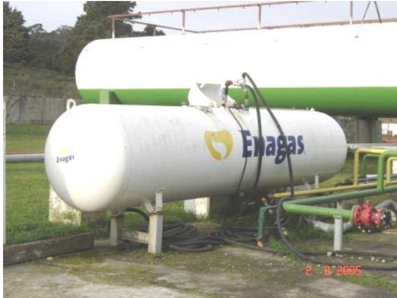
FIGURA 2.5 TANQUE DE ALMACENAMIENTO (DESCARGA DEL COMPRESOR) DEL SISTEMA NO. 1.
