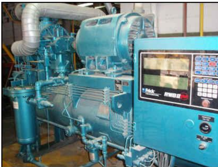
FIGURA 3.5 COMPRESOR DE TORNILLO FRICK RWB II PLUS
