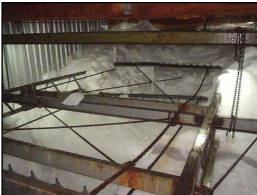
FIGURA 3.18 SILO DE HIELO #3
