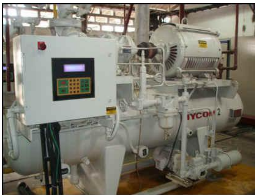
FIGURA 3.4 COMPRESOR DE TORNILLO MYCOM #2
