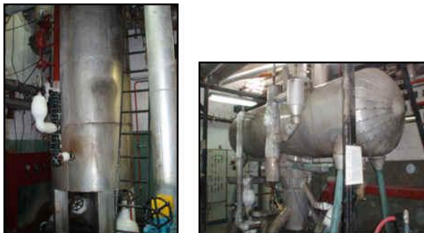
FIGURA 3.7 ESTACIONES DE BOMBEO DE LAS 2 SALAS DE MÁQUINAS
