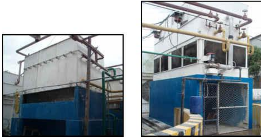
FIGURA 3.6 CONDENSADORES EVAPORATIVOS GRAM Y EVAPCO
