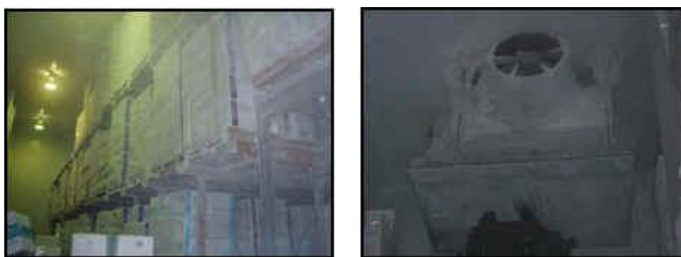
FIGURA 3.12 PERCHAS Y EVAPORADOR DE LA CÁMARA #4
