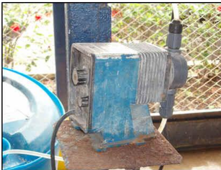
FIGURA 3.25 BOMBA DOSIFICADORA DE CLORO
