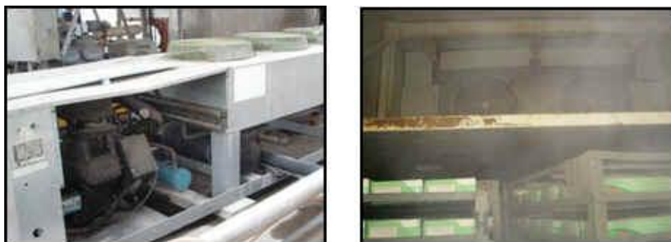
FIGURA 3.10 UNIDAD CONDENSADORA Y EVAPORADORES DEL TÚNEL #2
