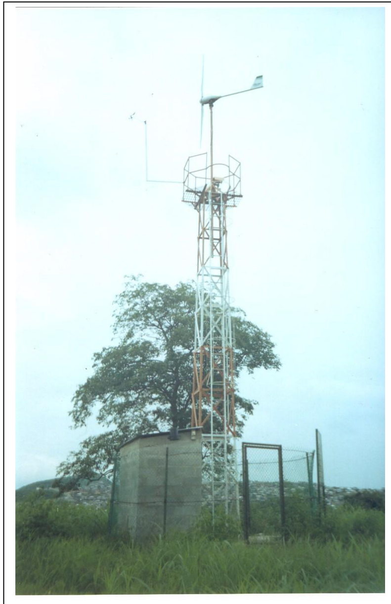
Figura 2.17: Generador eólico ubicado en el CENAE.
