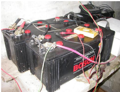
Figura 3.18: Baterías utilizadas en la estación
