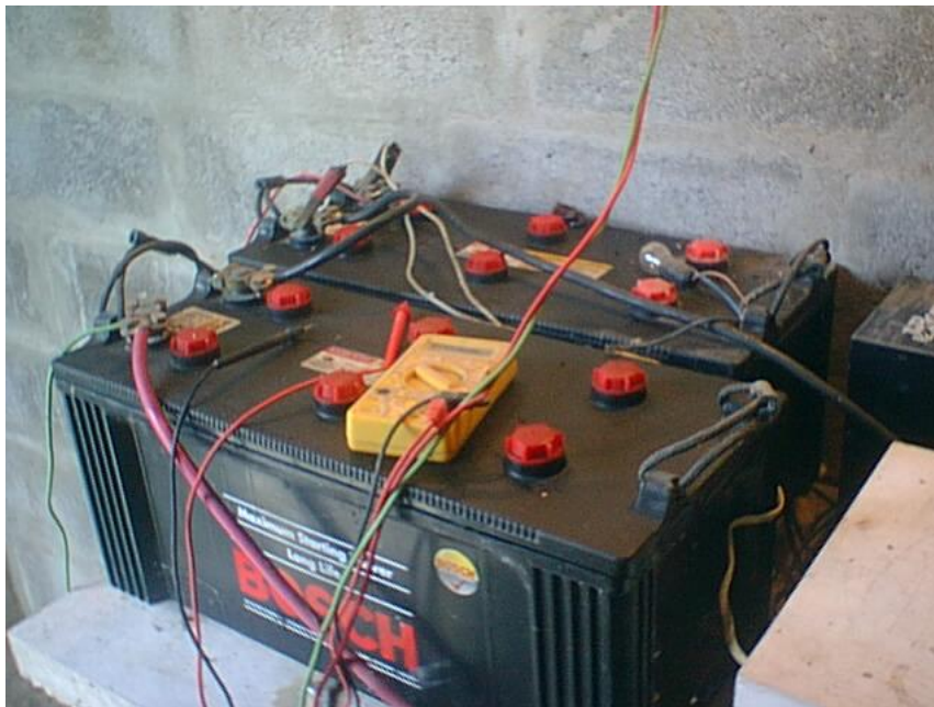
Figura 4.2: Baterías en la estación del GENAF
