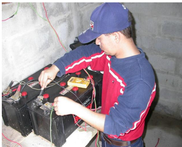
Figura 3.17: Medición del voltaje en las baterías
