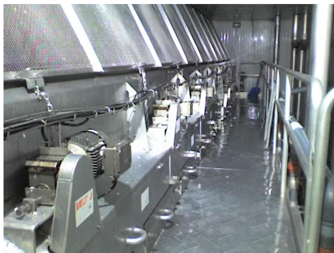
Figura 3.2 Foto del Túnel de congelación
