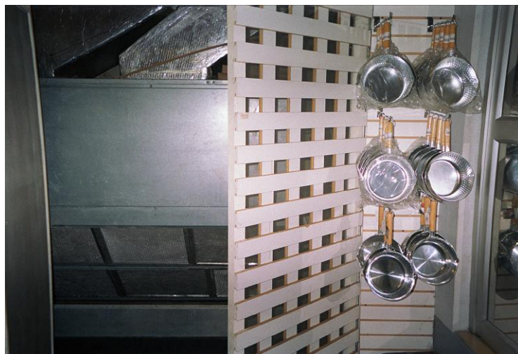
FIGURA 2.3 CUARTO DE EQUIPO DE UMA ( DETALLE DEL RETORNO )
