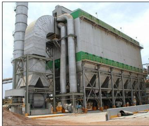
FIGURA 2.6 FILTRO DE PROCESO
