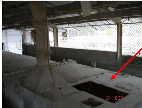
FIGURA 4.2. ENTRADA DE AIRE FALSO AL SISTEMA
