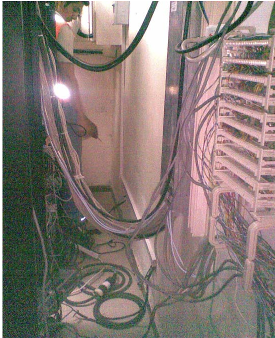
Fig. 4. 2 Cuarto de servidores en el área de oficinas
