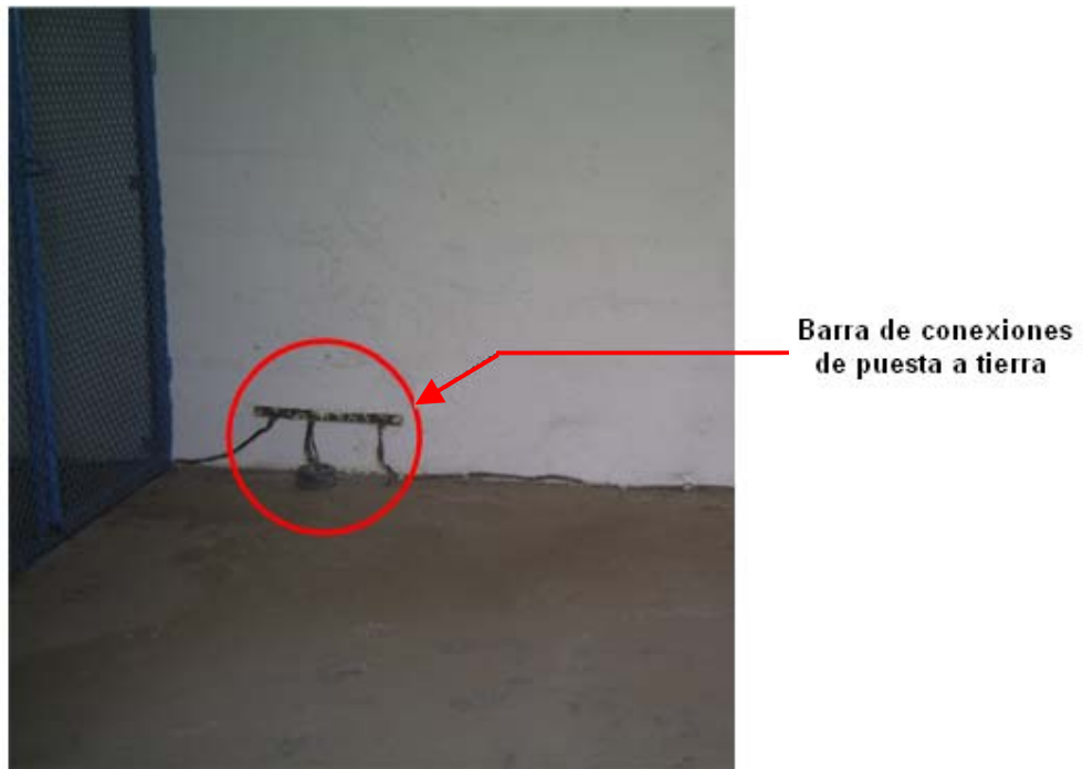
Fig. 3. 4 Barra de conexiones de puesta a tierra
