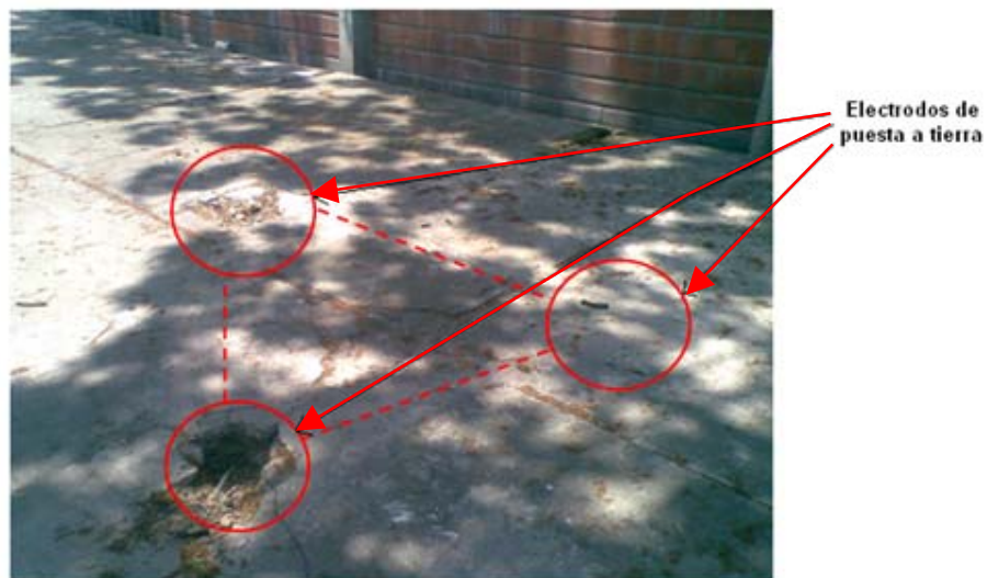
Fig. 3. 5 Sistema de puesta a tierra para equipos de cómputo – exteriores oficinas
