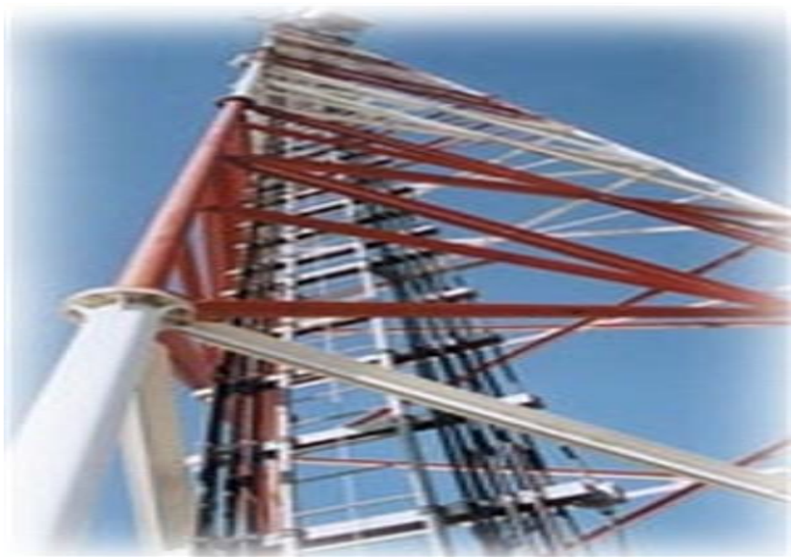
FIGURA 1.3 TORRE AUTOSOPORTADA PATA TUBULAR
