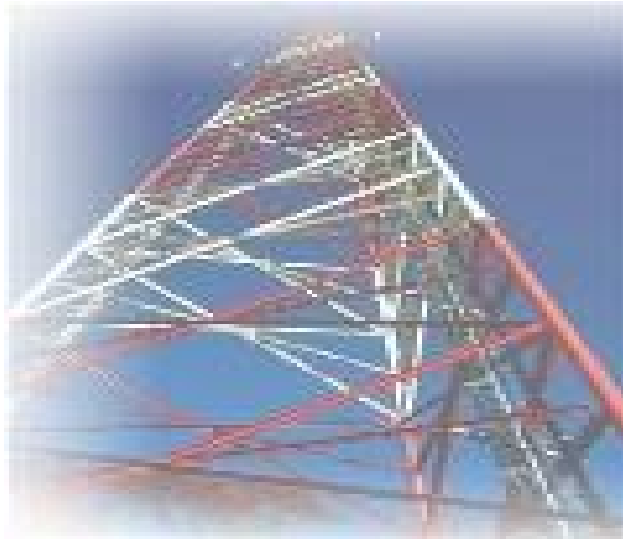
FIGURA 1.4 TORRE PATA SÓLIDA
