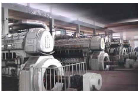
Fig. 1.5 Central Termoeléctrica Monay
