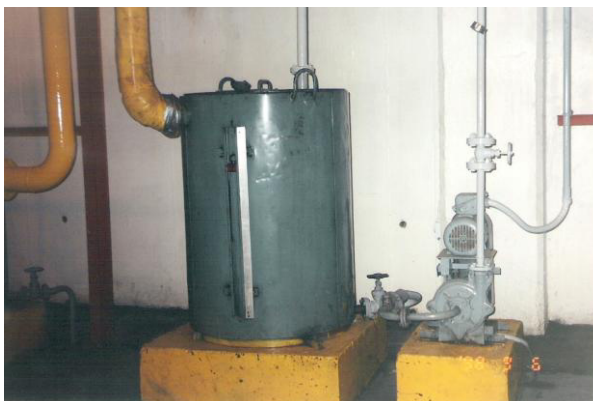
Fig. 2.4 Tanque de Lodos en la Planta Baja de la casa de Máquinas.
