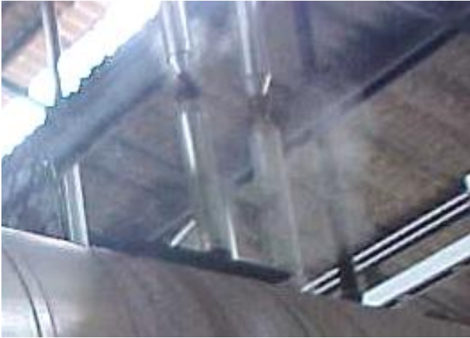
Figura 4.3. Fuga de vapor
