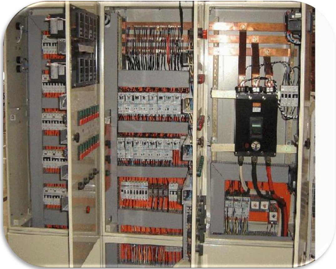
Fig. 12 Tablero eléctrico bien distribuido.
