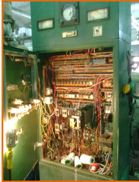
Fig. 6b Instalaciones Inseguras dentro de un TBT. Fuente: Fabrilana S.A. TBT de una maquina de tinturado.
