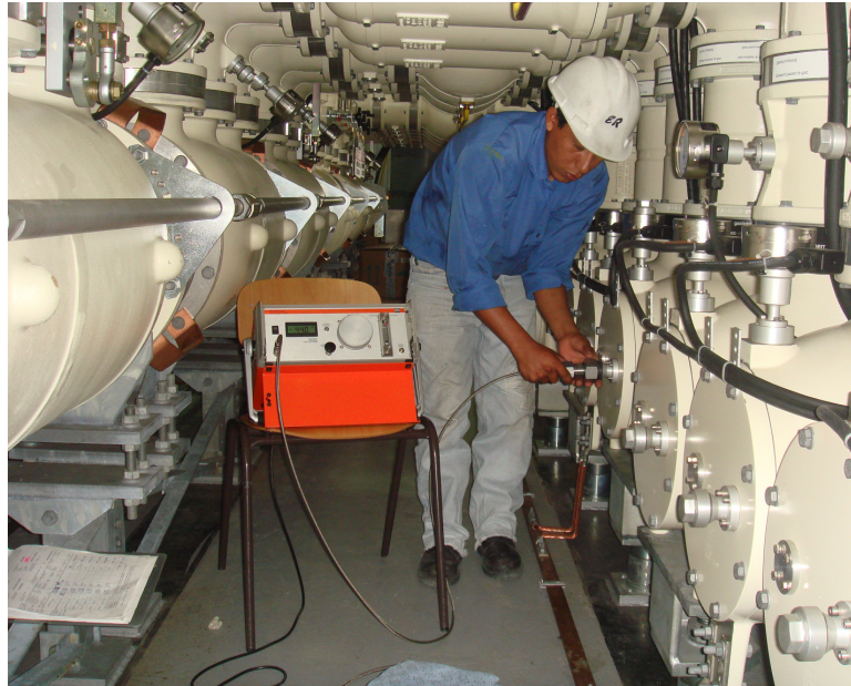
Fig 21a Equipo de medición de punto de rocío.
