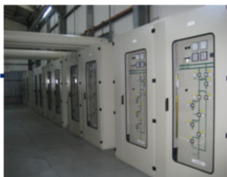
Fig. 41b. Tableros de control local.
