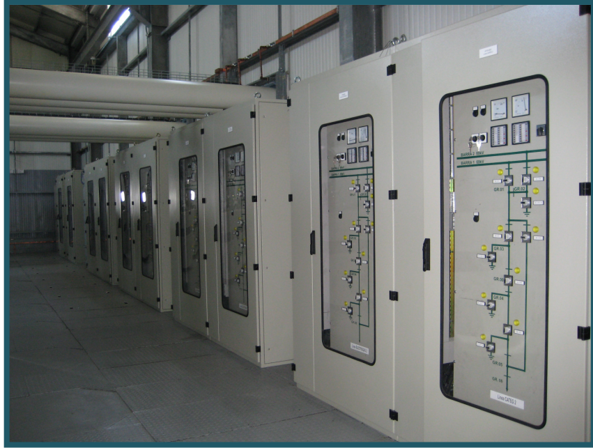
Fig. 13. Armarios de mando local
