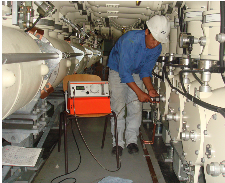
Fig 29. Equipo de medición de punto de rocío.
