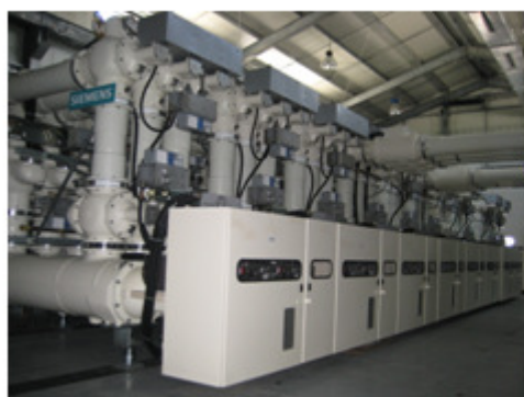
Fig. 41a. Equipo de Alta Tensión
