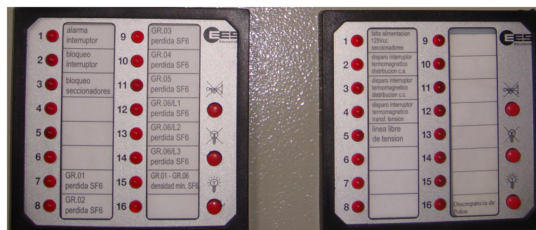
Fig 30. Panel de alarmas del Nivel Cero
