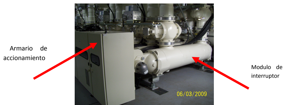
Fig. 8. Interruptor de potencia
