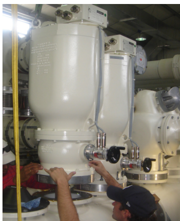
Fig. 11. Transformador de Potencial
