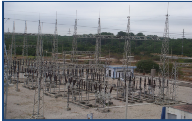
Fig 4. Patio de 138KV (Convencional)
