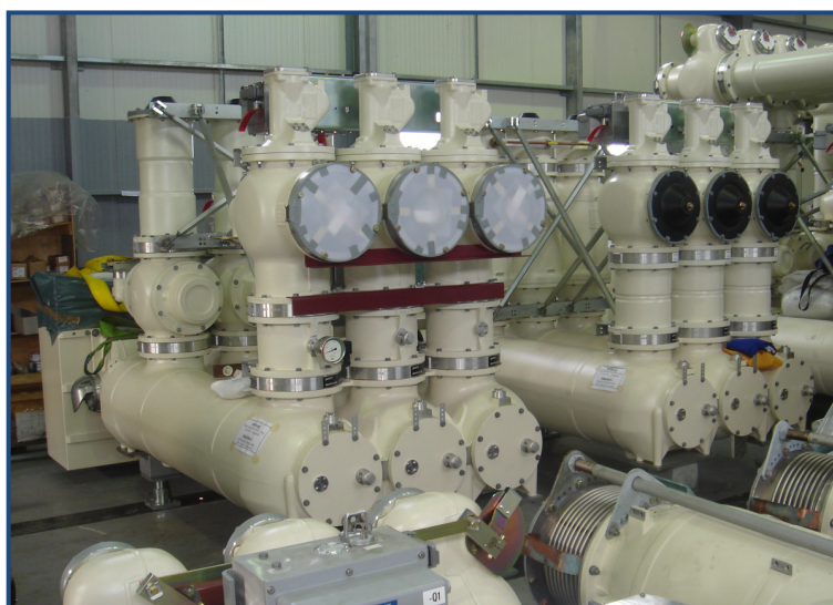
Fig 14. Modulo de bahía colocada en sitio de montaje
