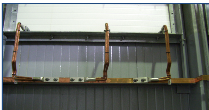
Fig 16. Barras de cobre para aterrizar la caseta de la GIS
