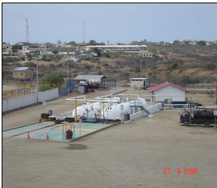
FIGURA 1.11 ESTACIÓN CASA BOMBA
