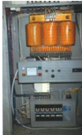
Figura 2.3. Transformador de aislamiento y dispositivo detector de fugas [4].
