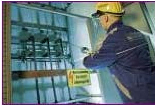
Fig. 1.2. Persona frente a un posible arco eléctrico.
