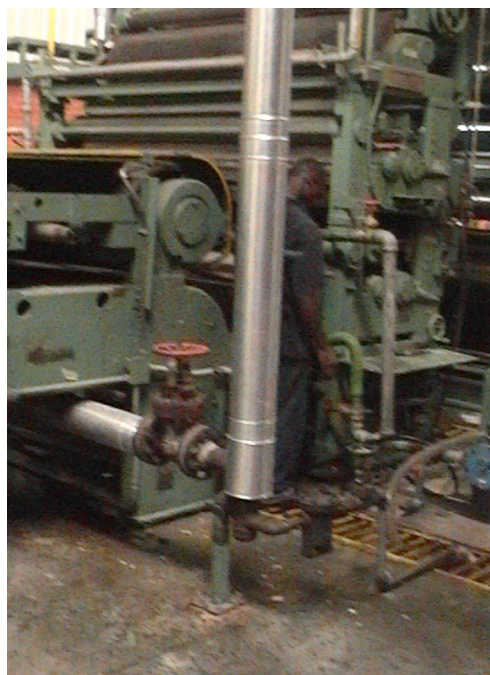
FIGURA 1.23 ALIMENTACION DE VAPOR Y RETORNO DE PLANCHAS CALIENTES (DOBLE BACKER)
