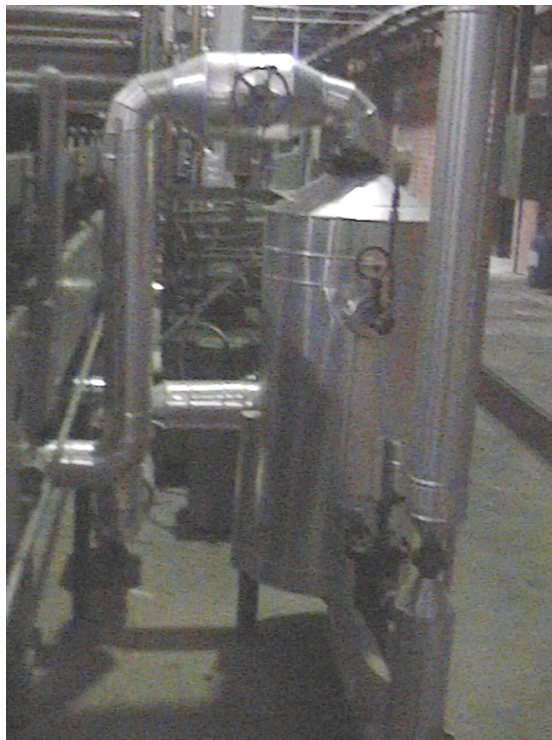
FIGURA 1.28 ALIMENTACION DE VAPOR FLASH EN PLANCHAS CALIENTES
