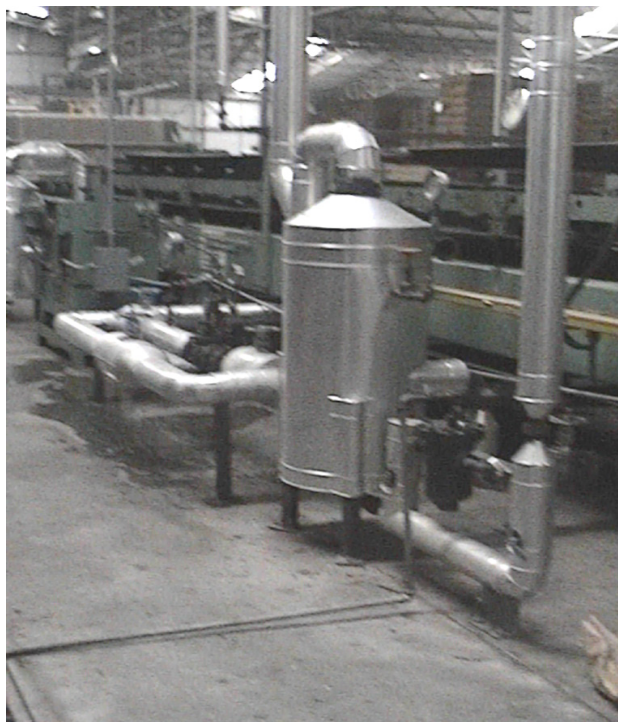
FIGURA 1.24 SISTEMA DE TANQUES FLASH EN PLANCHAS CALIENTES
