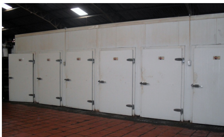
FIGURA 2.15 FOTO CÁMARA DE FERMENTACIÓN
