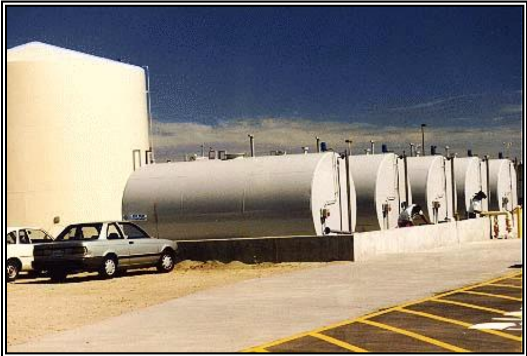
Figura # 1.3 "TANQUES EXPUESTOS A LA ATMOSFERA"
