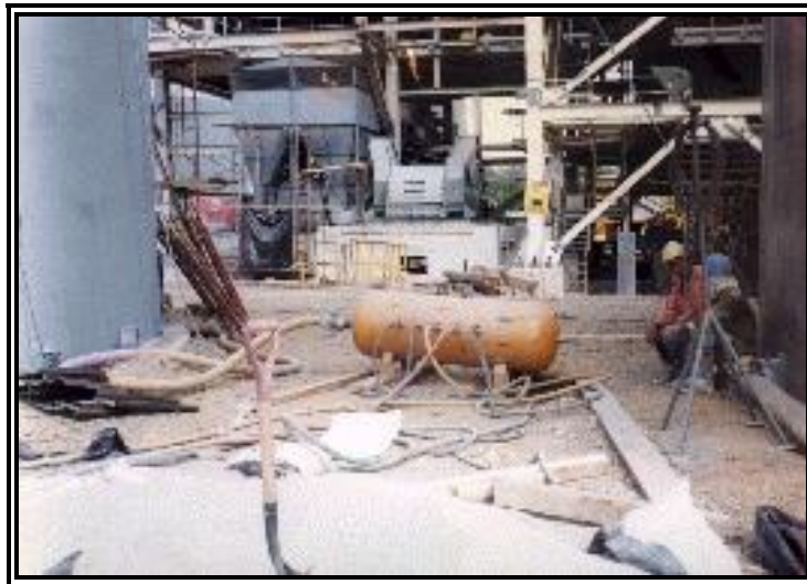
Figura # 2.17 "MALA DISPOSICION DE MANGUERAS"
