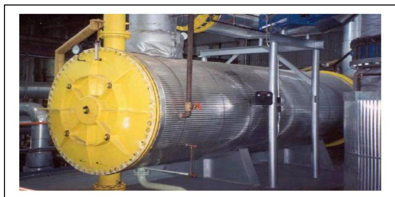
Figura 3.19 Intercambiador de Calor
