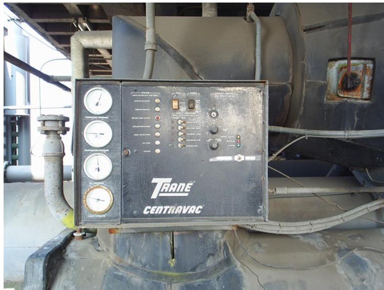
Figura 3.1 Tablero Control Parámetros Chiller.
