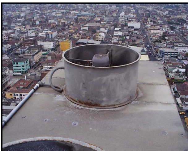
FIGURA 2.2. VISTA DE VENTILADOR INSTALADO EN LA PARTE SUPERIOR DE LA TORRE.
