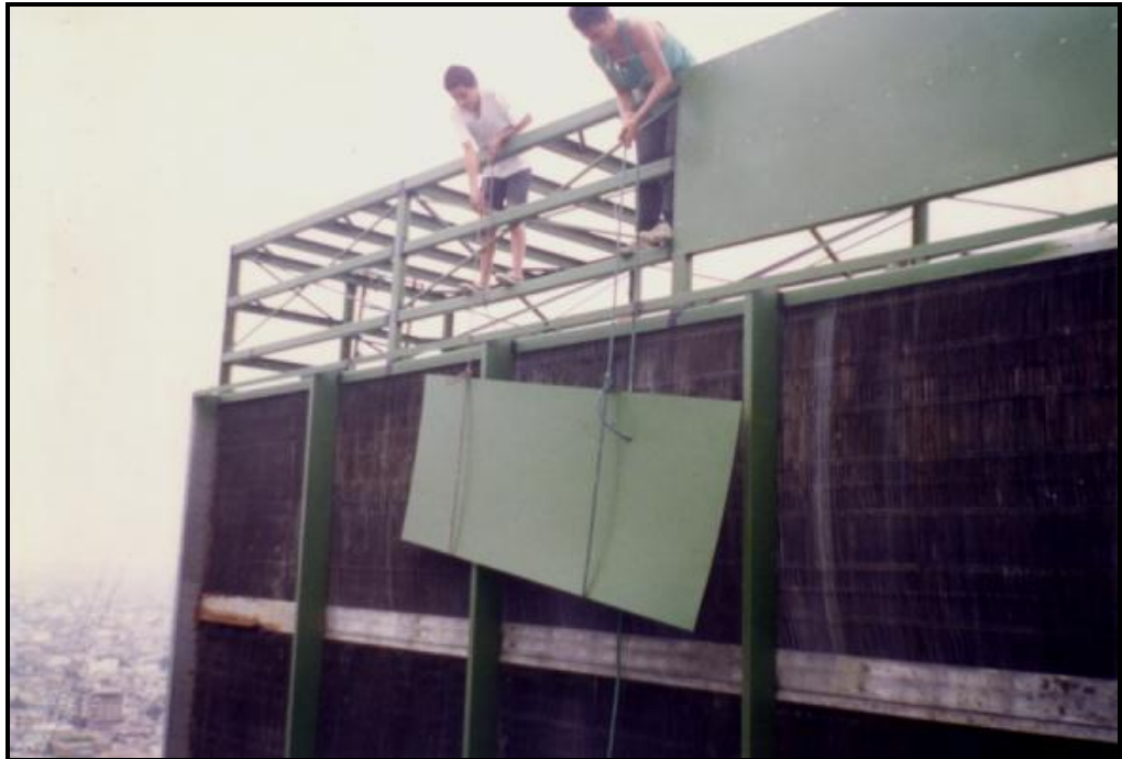
Figura 2.3. ARMADA PLENUM Y ESTRUCTURA BASE PARA VENTILADORES
