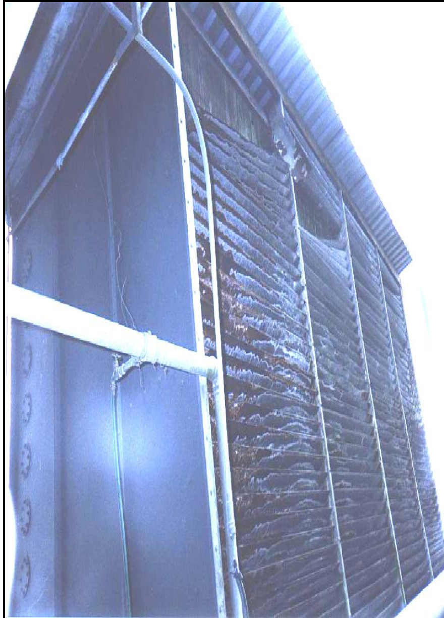
FIGURA 3.2 TORRE DE ENFRIAMIENTO 'CONDICIÓN ANTES'
