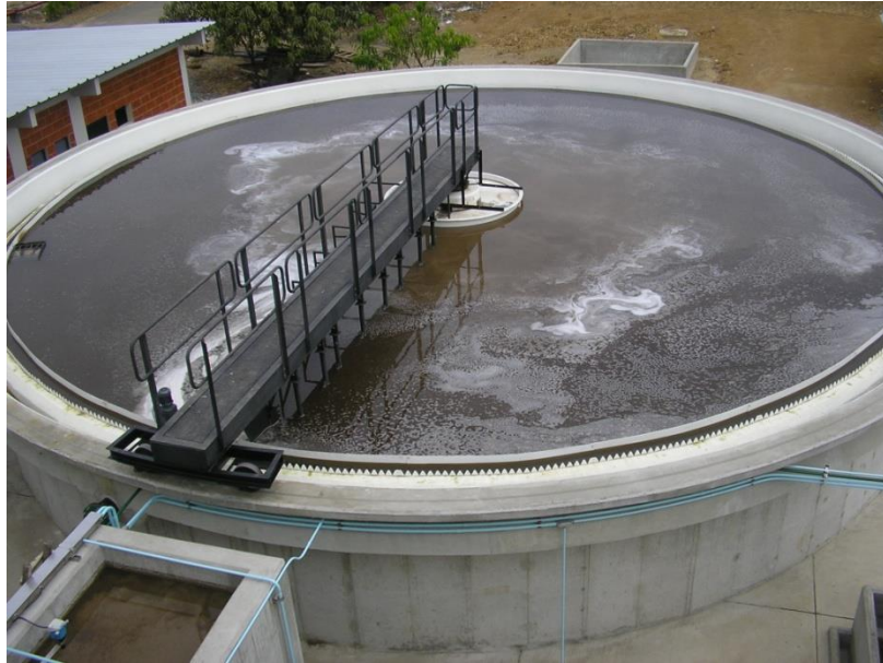
Decantador con puente Barrenador
