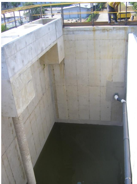
Vista de la canaleta Parshall previo llenado del tanque Anóxico
