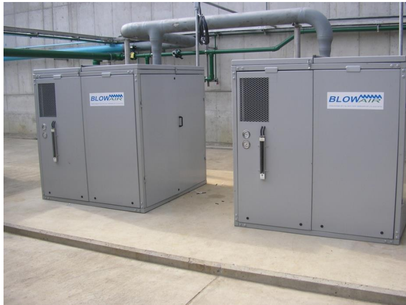
Generadores de Aire para difusores.
