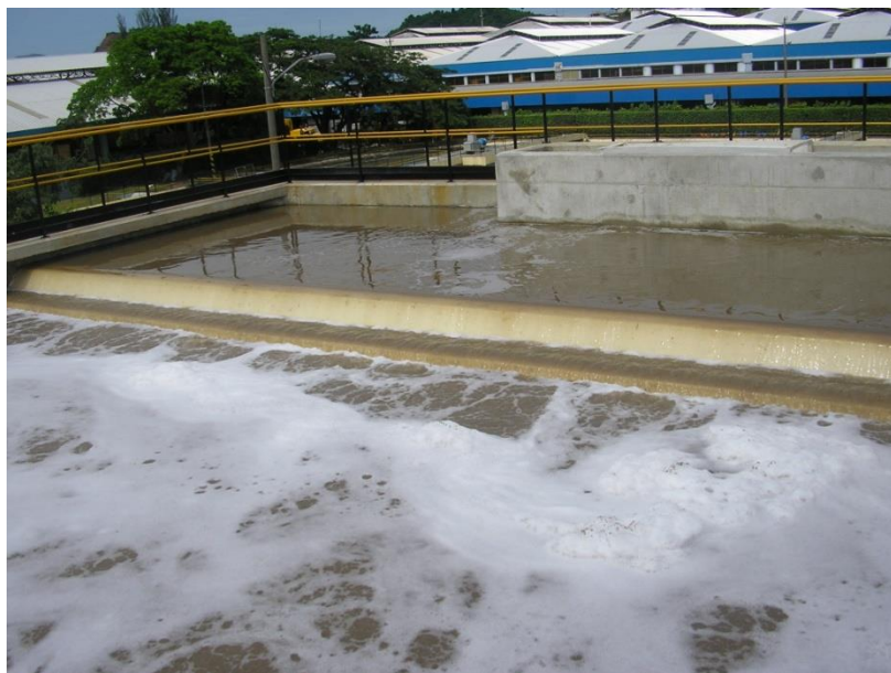
Tanque Anóxico alimentando a Tanque de Aireación
