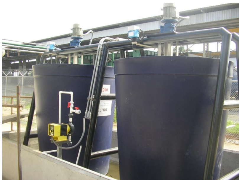
Cubeto de Polieléctrolitos con accesorios dosificadores.
