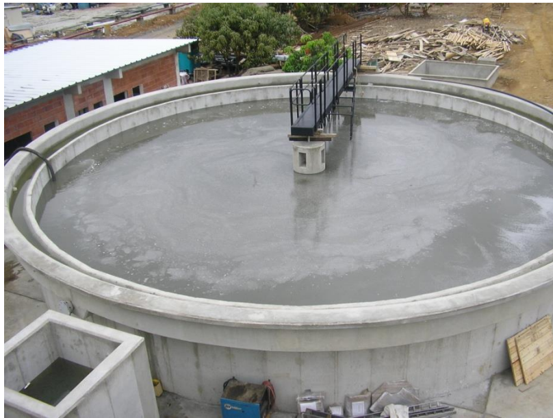
Decantador de lodos
