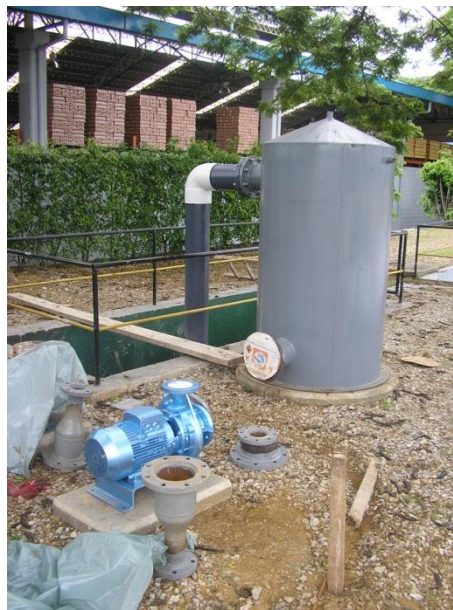
Pozo de bombeo a Tanque Anoxico
