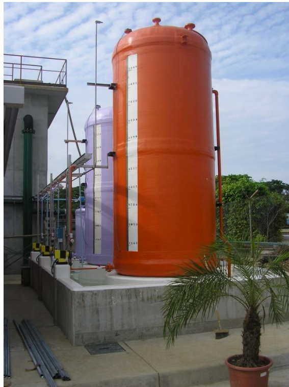
Dique con tanques de soda caustica y dosificadores.
