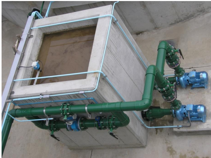
Tanque de lodos con sus accesorios y bombas de circulación.
