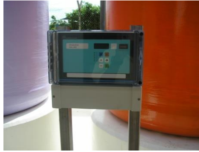
TRANSMISOR SENSOR DE NIVEL SODA - CLORURO
