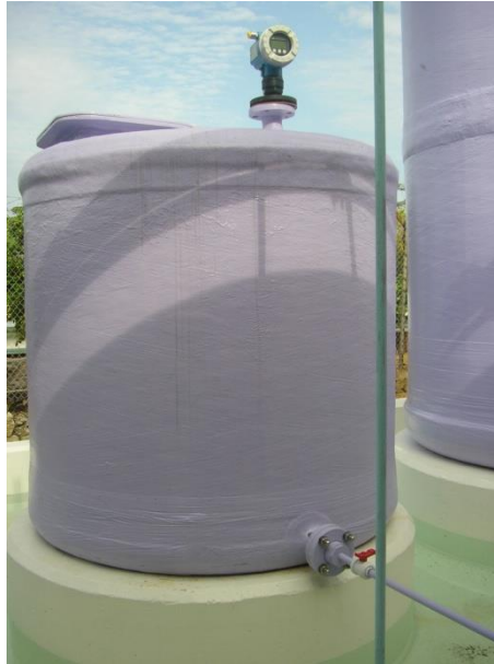
Dique de reactivos y dosificadores de químicos.
