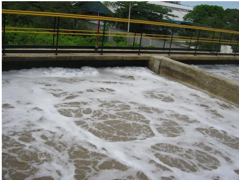
Tanque de Aireación y Anóxico en Puesta en Marcha.
