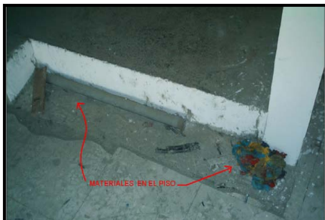
FIGURA 5.4 Materiales encontrados en la subestación.
