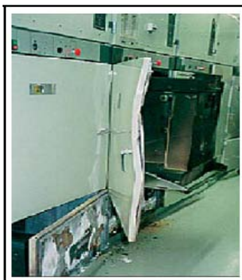
FIGURA 2.6 Consecuencia producida por una explosión
