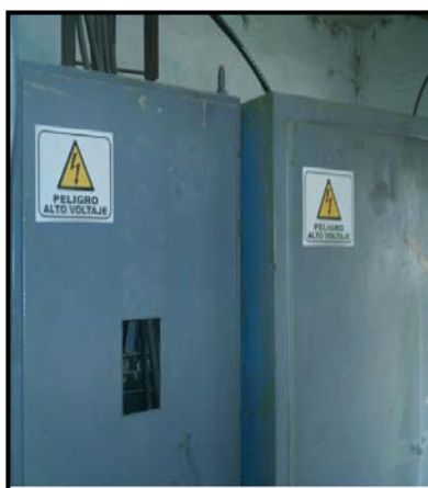
FIGURA 1.8 Tableros de distribución subestación REPLASA
