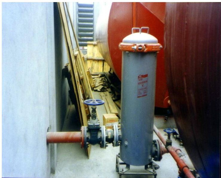
FIGURA 3.24 FILTROS PARA COMBUSTIBLE DIESEL
