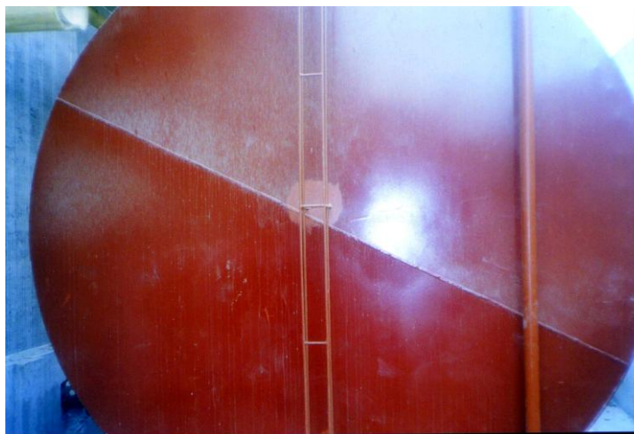
FIGURA 3.25. TANQUE DE ALMACENAMIENTO DE COMBUSTIBLE (VISTA LATERAL)
