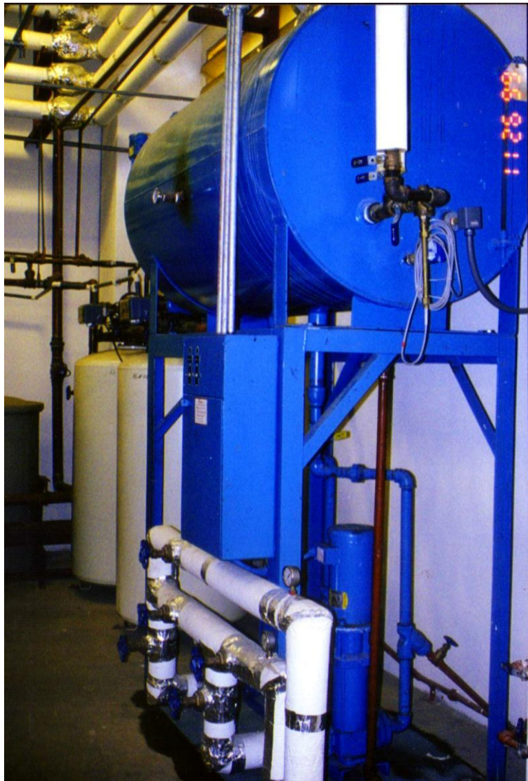
FIGURA 3.32. TANQUE DE RETORNO DE CONDENSADO (INSTALACIÓN TERMINADA)
