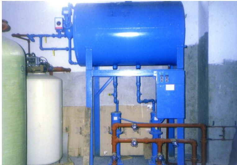
FIGURA 3.30. TANQUE DE RETORNO DE CONDENSADO AL INICIO DE LA INSTALACION
