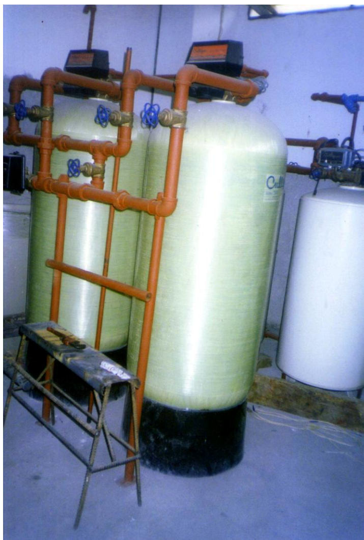
FIGURA 3.38. ABLANDADORES DE AGUA PARA EQUIPOS DE LAVANDERIA
