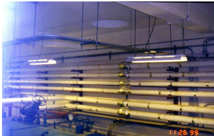
FIGURA 3.14. TUBERÍAS DE DISTRIBUCIÓN DE VAPOR EN CASA DE MÁQUINAS
