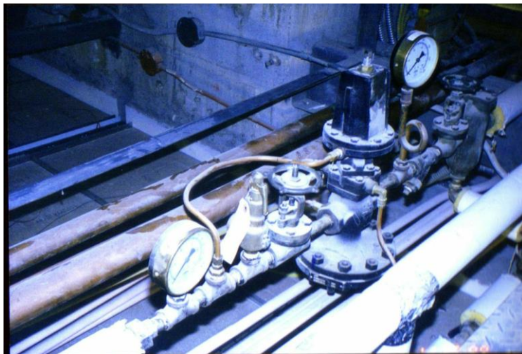
FIGURA 3.17. ESTACION REDUCTORA DE PRESION
