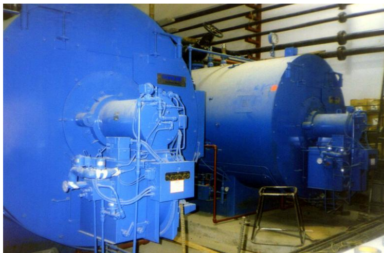
FIGURA 3.31. PARTE FRONTAL DE LOS CALDEROS
