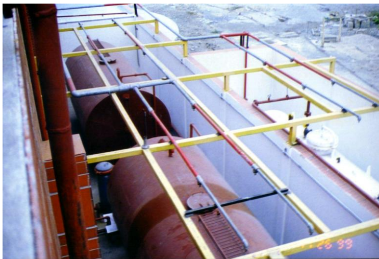
FIGURA 3.21. TANQUE DE ALMACENAMIENTO DE COMBUSTIBLE
