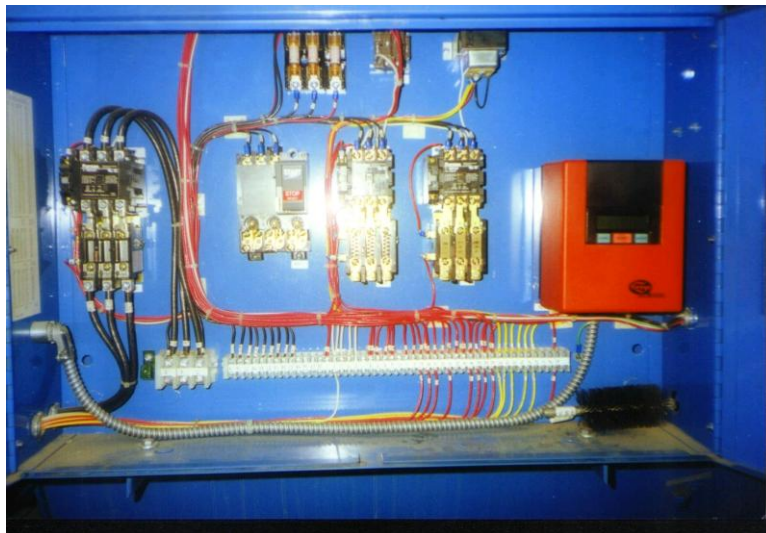
FIGURA 3.34. TABLERO ELECTRICO CON MODULO LECTOR DE FALLAS DE LOS CALDEROS
