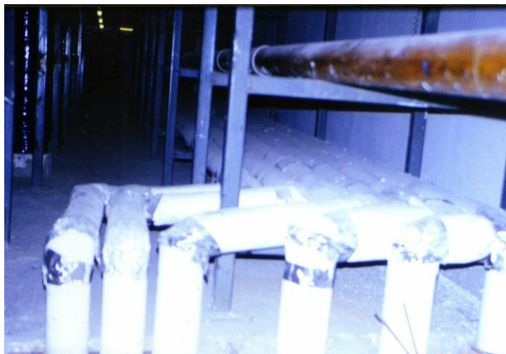
FIGURA 3.16. DISTRIBUCIÓN DE TUBERÍAS DE VAPOR EN EL TUNEL SOBRE CASA DE MAQUINAS
