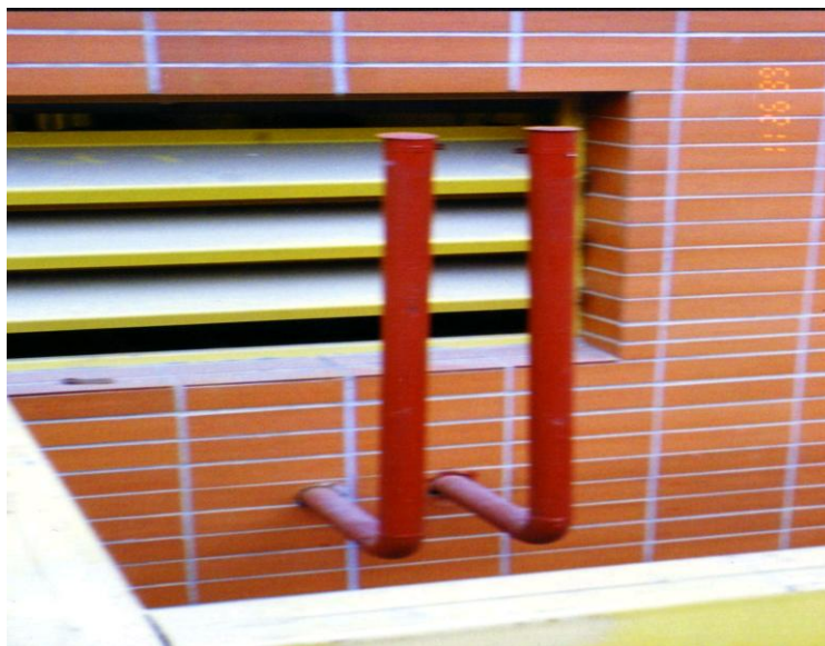
FIGURA 3.20. TUBERÍAS DE DESFOGUE DE LAS VÁLVULAS DE SEGURIDAD DE LOS CALDEROS
