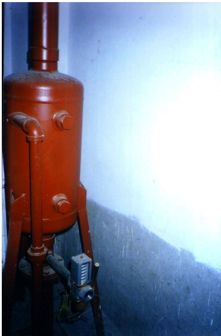
FIGURA 3.41. TANQUE BLOW DOWN (INICIO)
