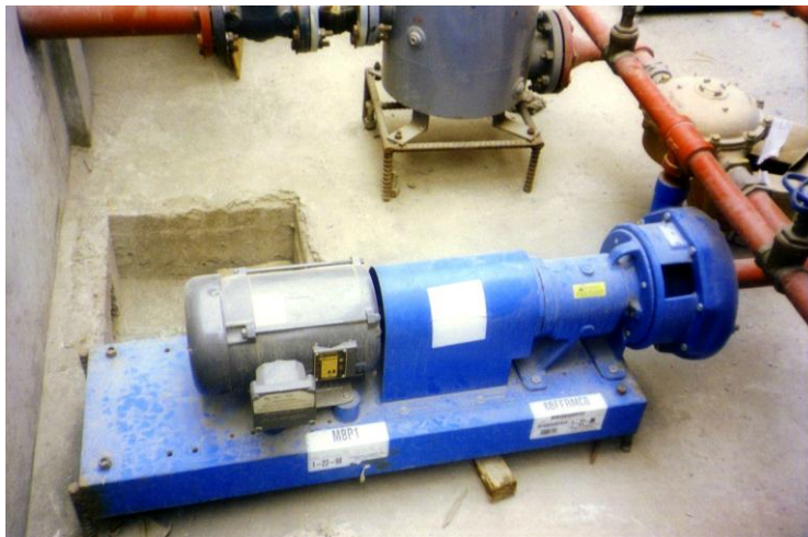
FIGURA 3.26. BOMBA DE SUMINISTRO DE COMBUSTIBLE
