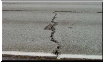
Figura 20. Despostillamiento de juntas.
