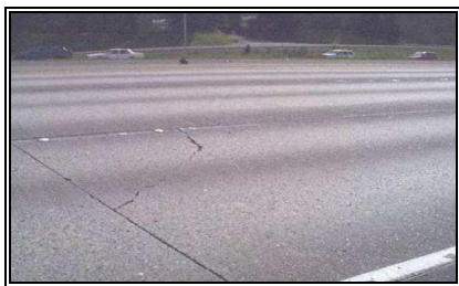
Figura 17. Rotura de esquinas.
