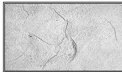
Figura 14. Fisuras por retracción superficial.
