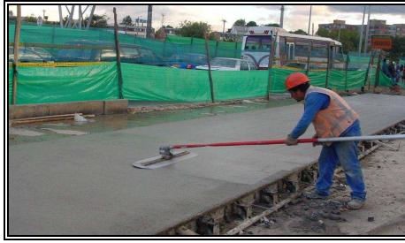
Figura 6. Flotado del concreto.
