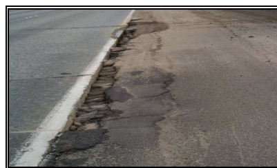
Figura 18. Erosión por bombeo.
