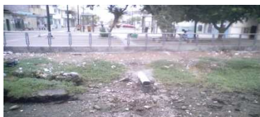
Foto JPG 8: Tubo de desagüe a la vista (Descarga directa en el estero)
