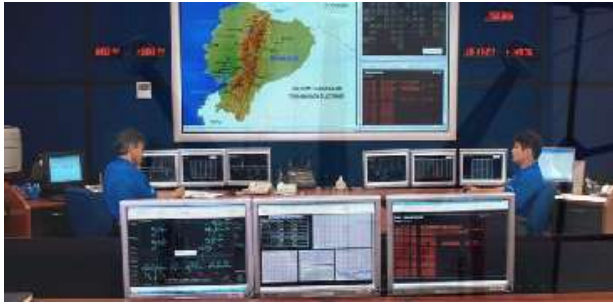
Figura 7 Centro de Control del S.N.T de CELEC EP - TRANSELECTRIC (C.O.T).
