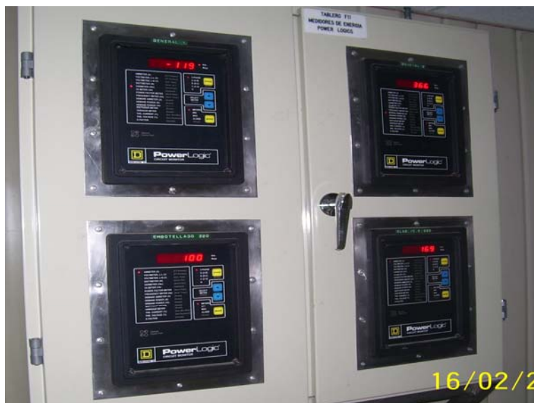
FIGURA 5.4 Medidores Power Link
