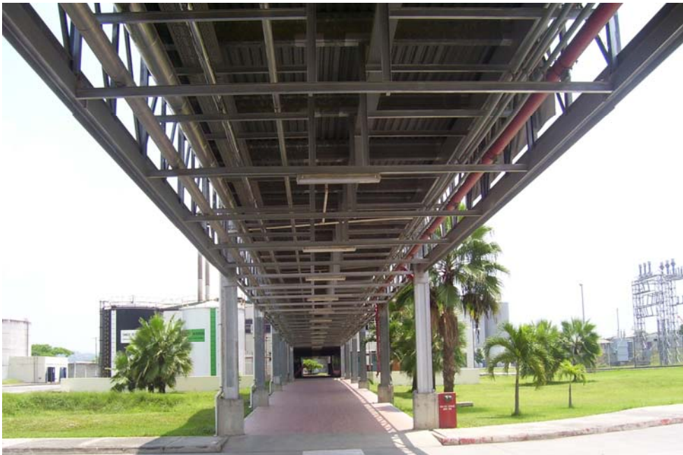
FIGURA 2.1 Iluminación de corredor de planta.
