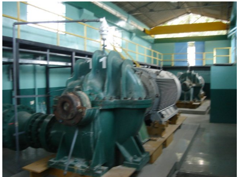
Figura 1.5. Motores trifásicos (Estación de Bombeo2)
