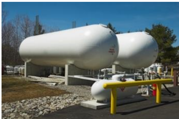
Figura 3.2.1: Tanques Fijos o Estacionarios Fuente: Empresa Comercializadora de GLP
