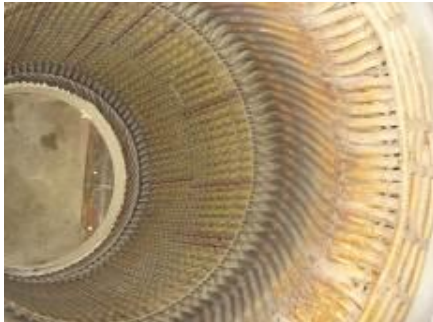
Figura 3. Deterioro del esmalte en rejillas del estator
