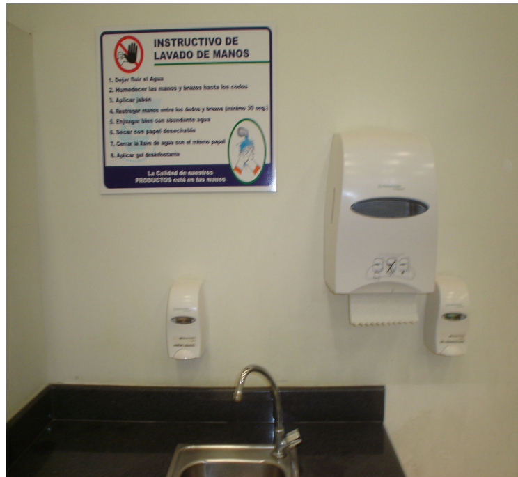
FIGURA 3.3 LAVADERO DE MANOS
