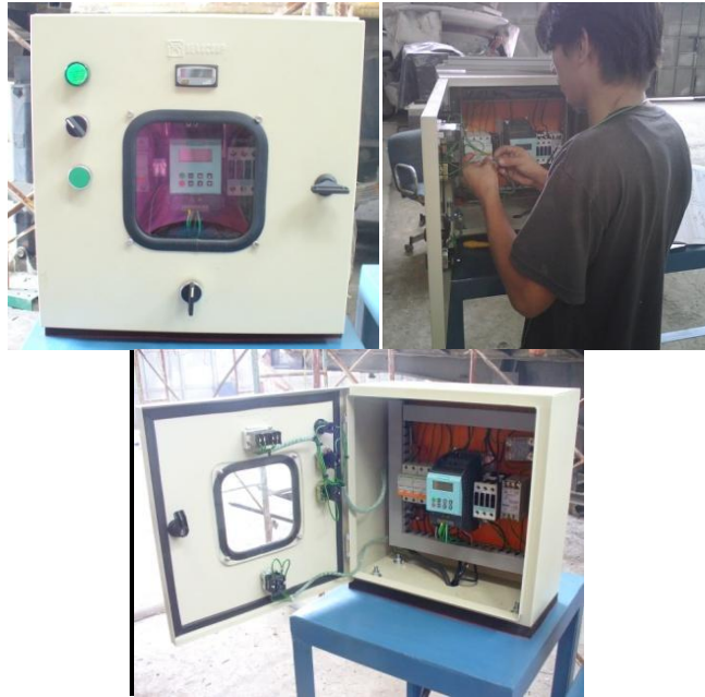
FIG. 2.24 PROCESO DE MONTAJE DE INTERRUPTORES Y BOTONES EN EL TABLERO DE CONTROL
