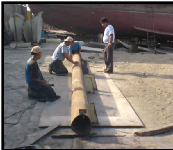
Figura N°11. Tubo para túnel del eje.
