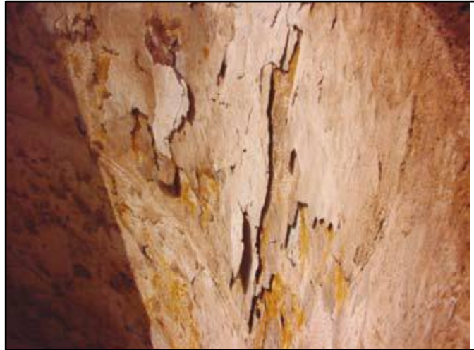
FIGURA 1.6. CORROSIÓN INTERNA EN UNA CHIMENEA. [16]
