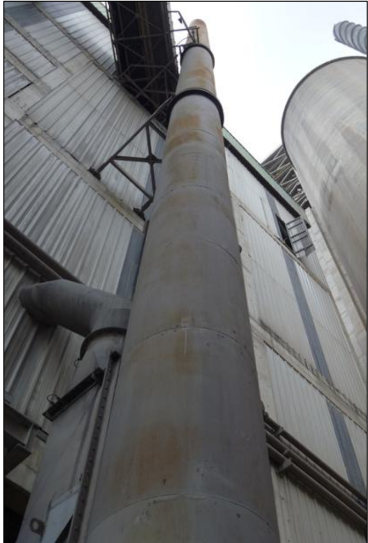
FIGURA 2.4. CORROSIÓN GENERALIZADA EN LA CHIMENEA
