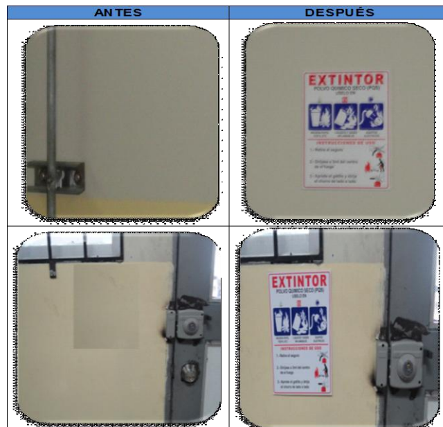
FIGURA 4.5. SEÑALES DE EXTINTORES
