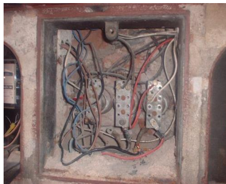
Fig.1. 5 Instalaciones eléctricas en malas condiciones
