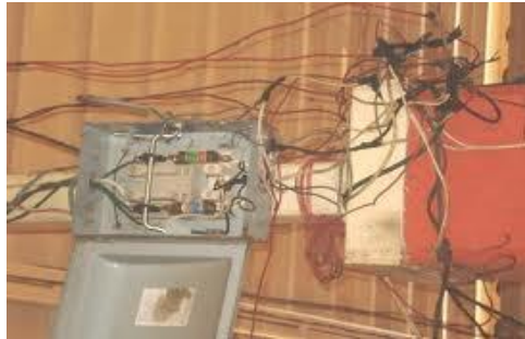
Fig.1. 7 Conexiones Provisionales inadecuadas
