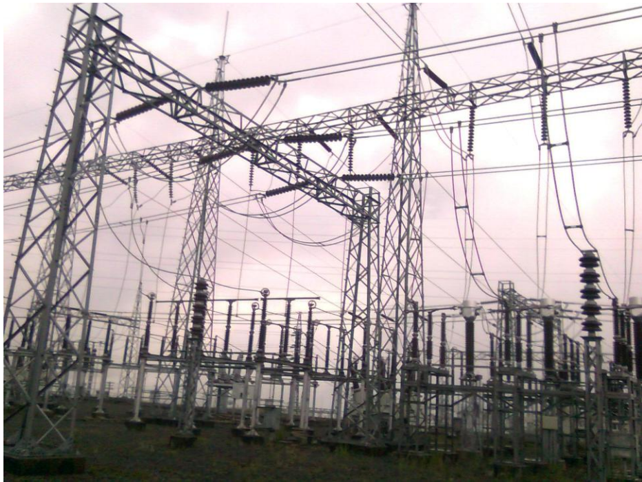
Figura 1. 1 Santa Rosa 230 / 138 / 46 kV, ubicada en la provincia de Pichicha, Ecuador.
